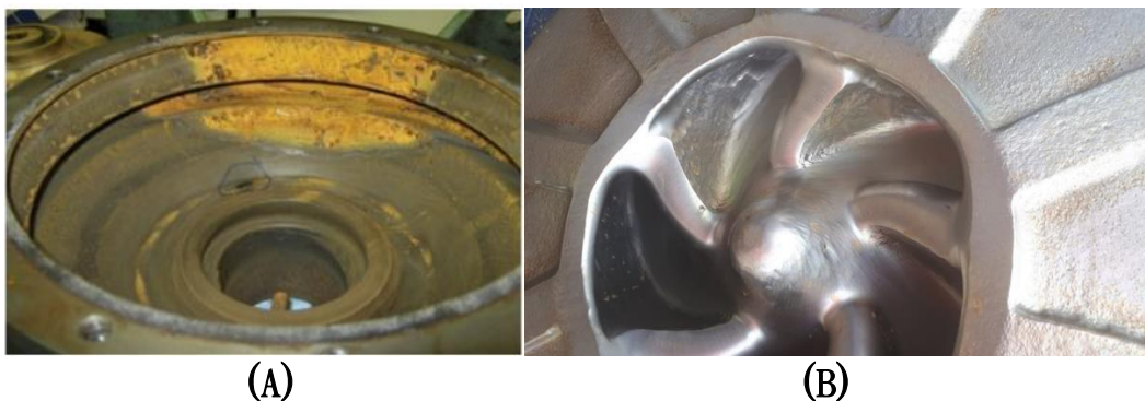
圖 14 (A) 嚴重磨損的泵殼，(B) 嚴重磨損的葉輪
