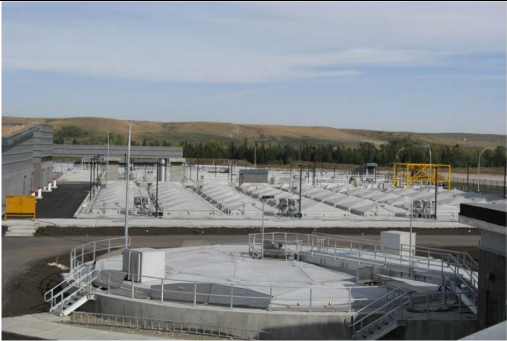
圖 7 加拿大阿爾伯他省 Calgary Pine Creek 污水處理廠之單段靜態發酵池/濃縮池
